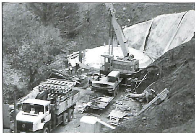
Nouveau réservoir d'eau du Bâa
